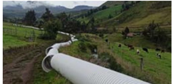
Vista general de la tubería de la red principal del sistema de agua
