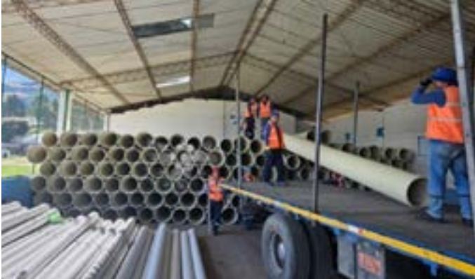
Tubería para el sistema de riego El Pisque
