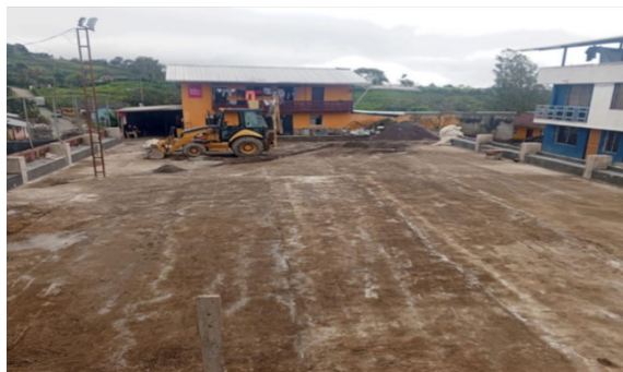
Base de hormigón, estructura metálica, iluminación y drenaje en la cancha de uso múltiple del barrio El Porvenir, parroquia Gualea, cantón Quito - Antes
