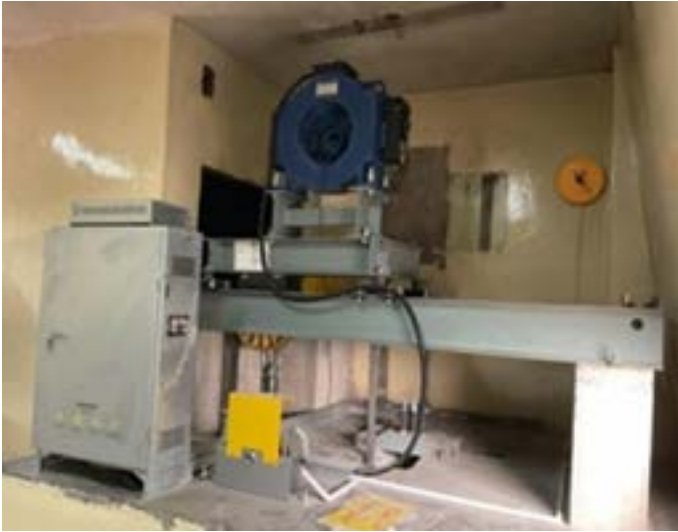
Cuarto de maquinas
