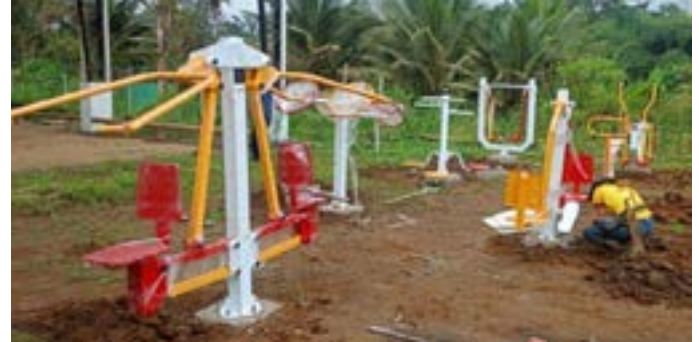
Ejercitadores instalados en el recinto Grupo Mieles
