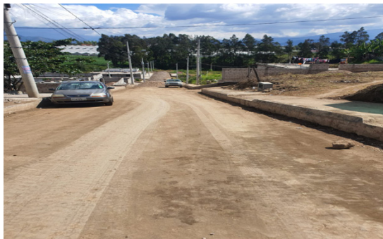
Adoquinado de varias calles De Los Molinos, barrio La Victoria, parroquia Yaruquí, cantón Quito - Antes
