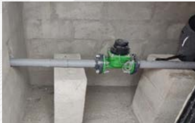
Medidor de riego instalado en el ramal 45C en Malchinguú
