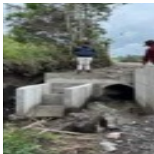
Obra de protección y distribución de caudales (acequia Güitig)
