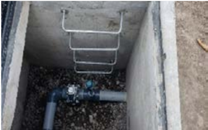
Válvula seccionadora instalada en las redes terciarias del ramal 44C en Malchingui.
