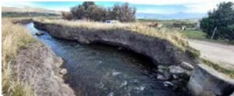
Tramos críticos del canal principal del sistema de riego Guanguilquí
