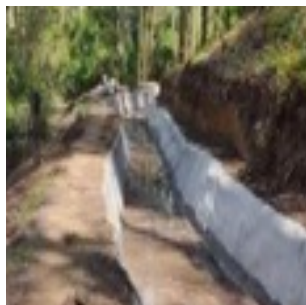
Manto de hormigón, sistema de riego Tumbaco
